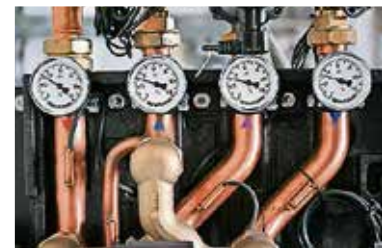
Verschiedene Messanzeigen an einer Gasheizung.
